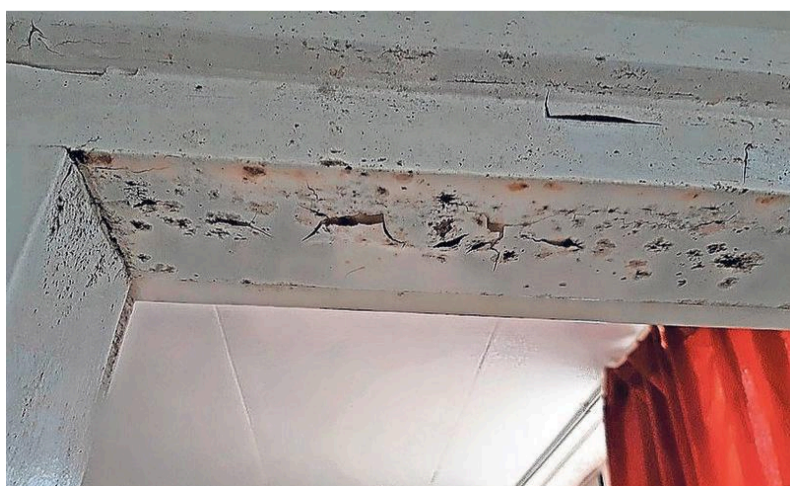
Schimmel in een deurpost.
